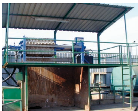
DEPURADORA AGUAS DECAPADP 2M3/H "PLANTA LACAMF2".
