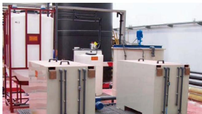
DEPURADORA CON 2 MÓDULOS "METALEX".
