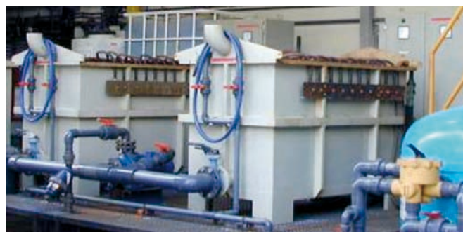
FABRICACIÓN DE COAGULANTE EN MÓDULOS "METALEX".
